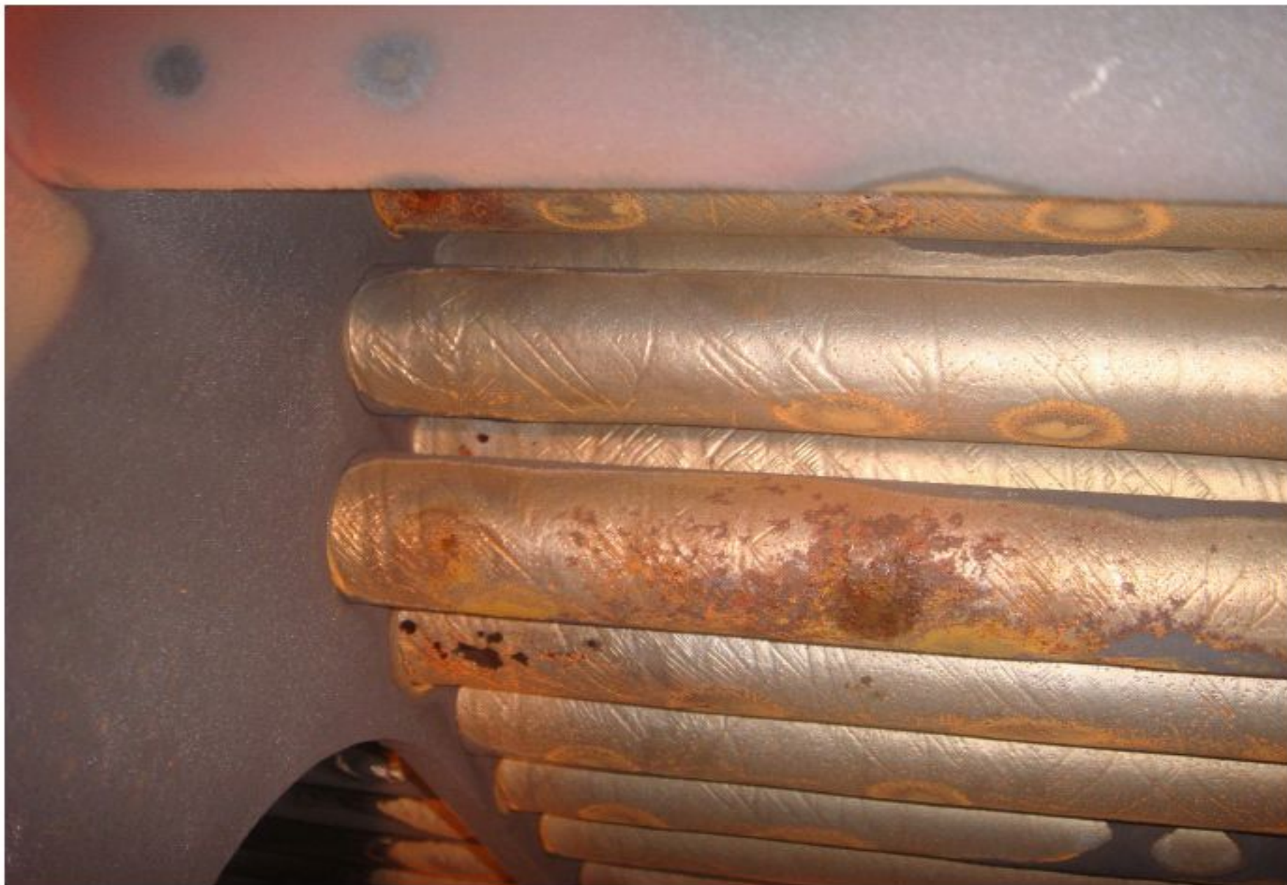
Widok rurek wymiennika przy przegrodzie.
